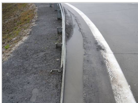
Obr. 7 – Nefunkčnost odvodnění se nejlépe zjistí za „nepříznivého“ počasí
